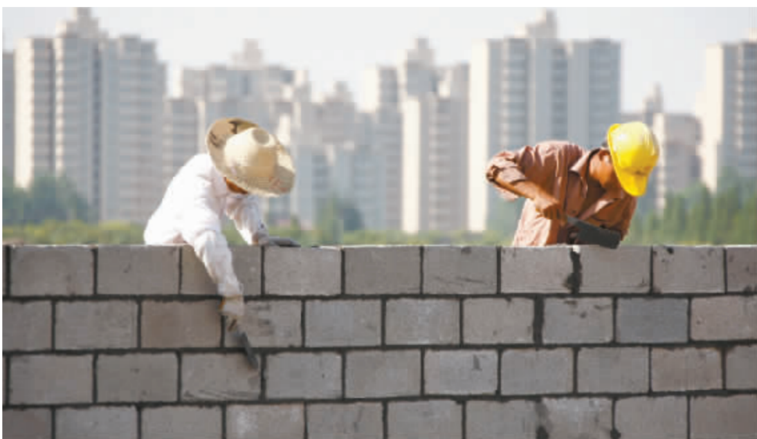
25日,上海颁布《上海市经济适用房管理试行办法》。图为两名工人在上海浦东三林经济适用房基地施工。新华社图
